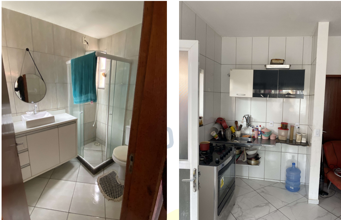
Fotos 28 e 29: Banheiro e cozinha possuem revestimento cerâmico nas paredes, teto não apresenta umidade. Fonte: Perito
